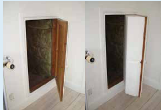
Uisoleret skunklåde til venstre og til højre efterisoleret med 200 mm samt tætnet med en fleksibel klemliste langs lågekanten.
